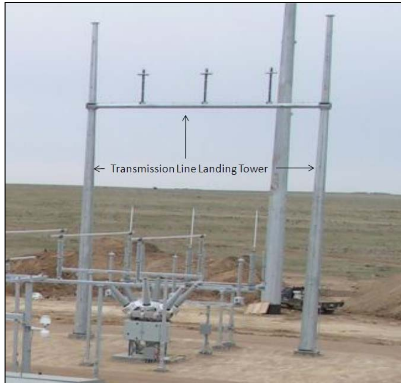
Imagen 32. Torre de Líneas de Transmisión
