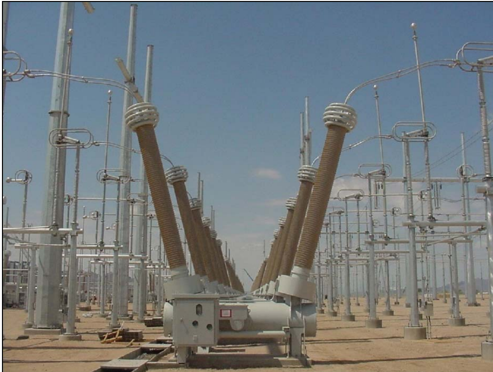
Imagen 27. Disyuntor de 500kV con un CB por fase
