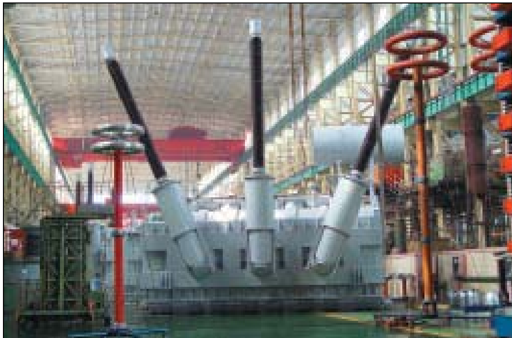
Imagen 31. Transformadores de 500kV
