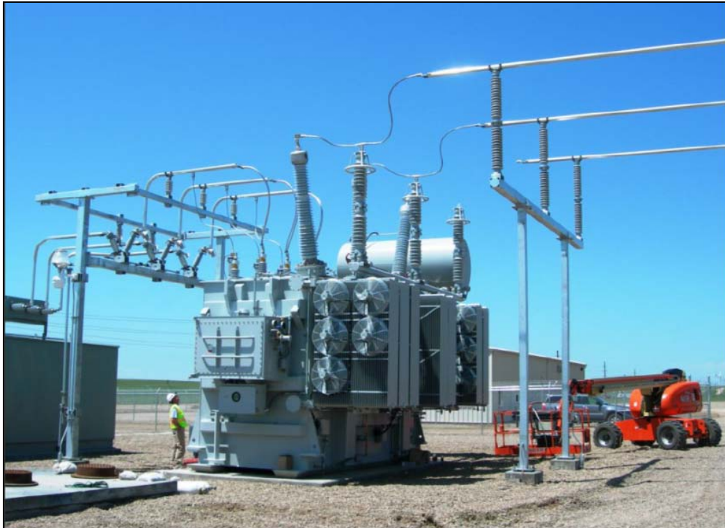
Imagen 30. Transformador principal de un Parque Eólico.
