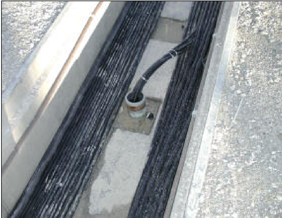
Imagen 23. Detalle del cableado de control.
