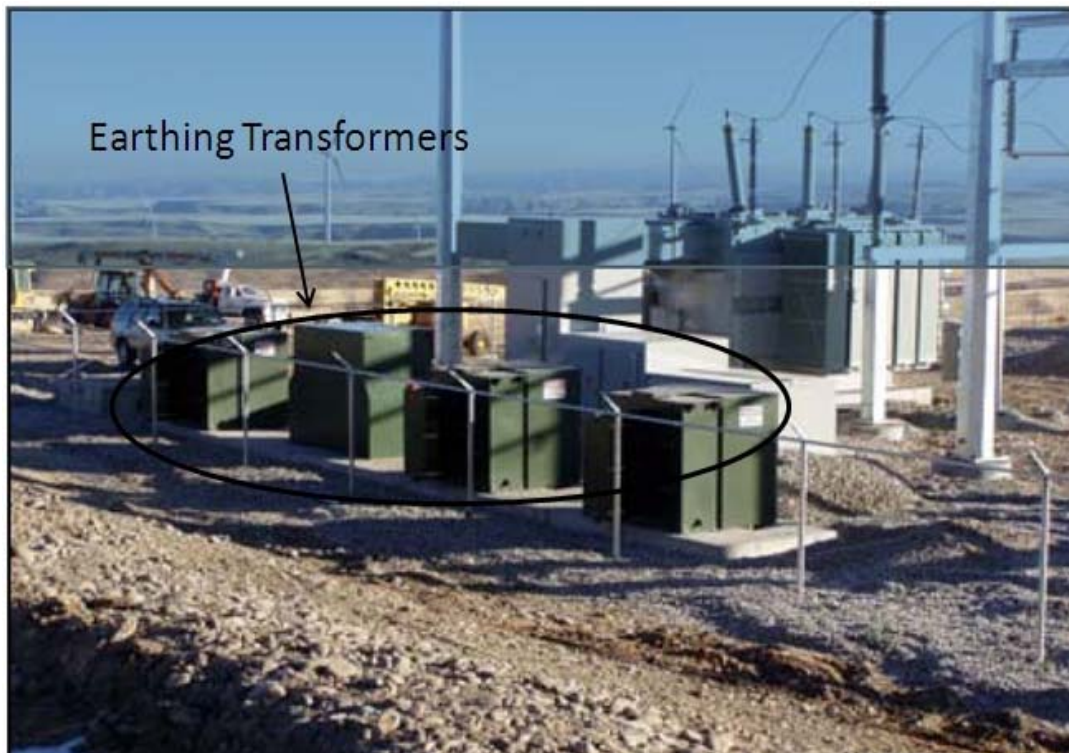
Imagen 21. Transformadores auxiliares/puesta a tierra
