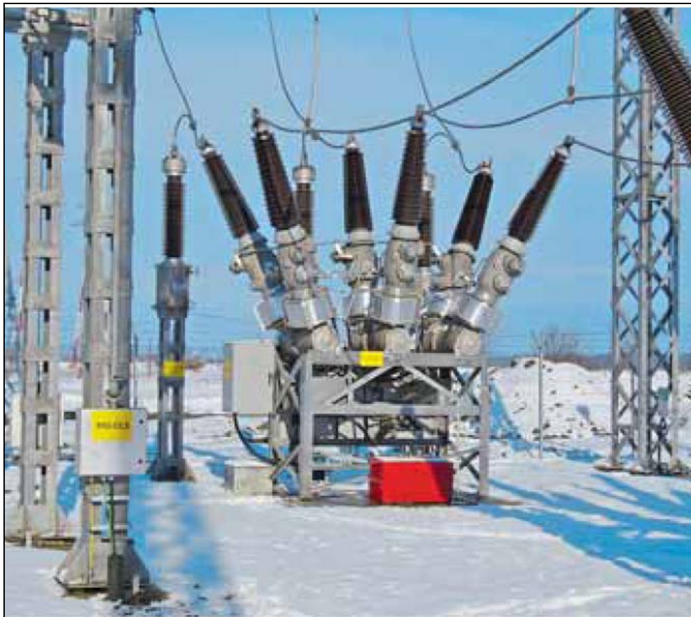
Imagen 26. Disyuntor de Protección.
